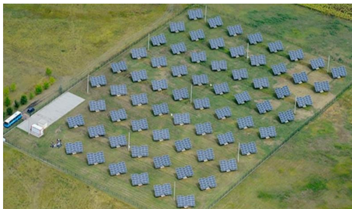
Fig. 6.4. Solar panel farm in Újszilvás.
